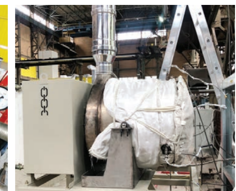
Рис. 4. Тепломеханический блок МГТУ на испытательном стенде
